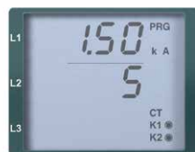
Programação do transformador de corrente
